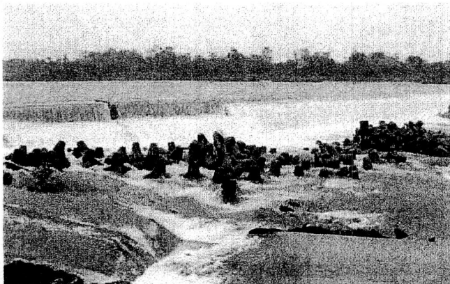
増水で滝のようになった明戸のサイフォン。魚道はないため、遡上する魚はここで行き止まりになる。
