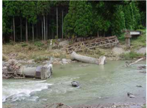
JR 越美北線第三足羽川橋梁の落橋 (美山町高田)
